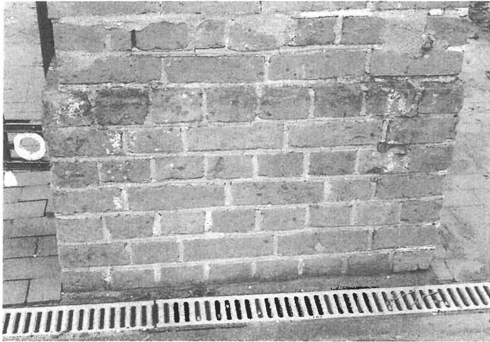
Fot. 3. Runowo, zbliżenie na cokół śłupa. Widoczne wykwity mikroorganizmów, oraz nieestetyczne uzupełnienia spoin.
