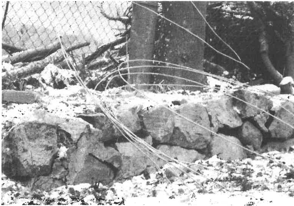
Fot. 17. Runowo, strona wschodnia, zbliżenie na relikty kamiennego muru, kamienie luźne, brak zaprawy.
