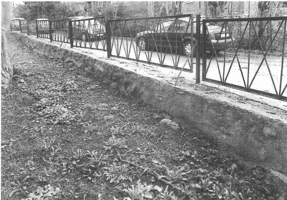
Fot. 11. Runowo, strona północna ogrodzenia. Widoczne silne porażenie biologiczne muru, mur niemal w całości pokryty jest szlichtą cementową.
