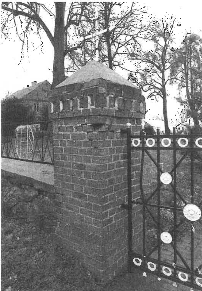
Fot.4. Runowo, widok na słupek bramy. Widoczne ubytki narożnych cegieł.
