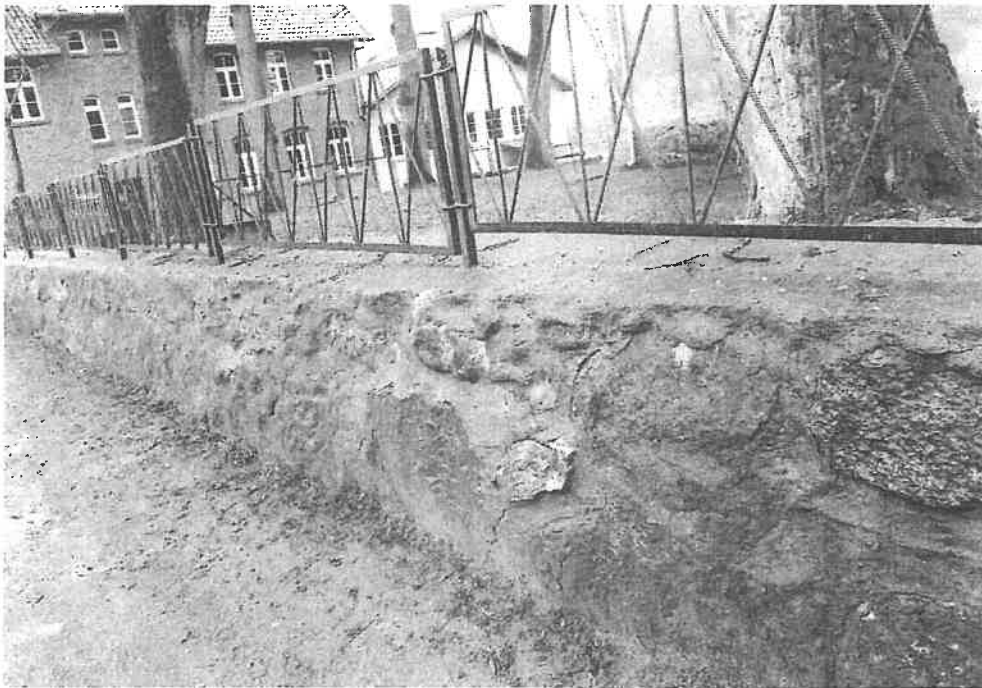
Fot. 15. Runowo, strona północna od zewnątrz, widoczna duża ilość uzupełnień cementowych w dużej mierze przekrywających kamień. U góry wylewka cementowa.
