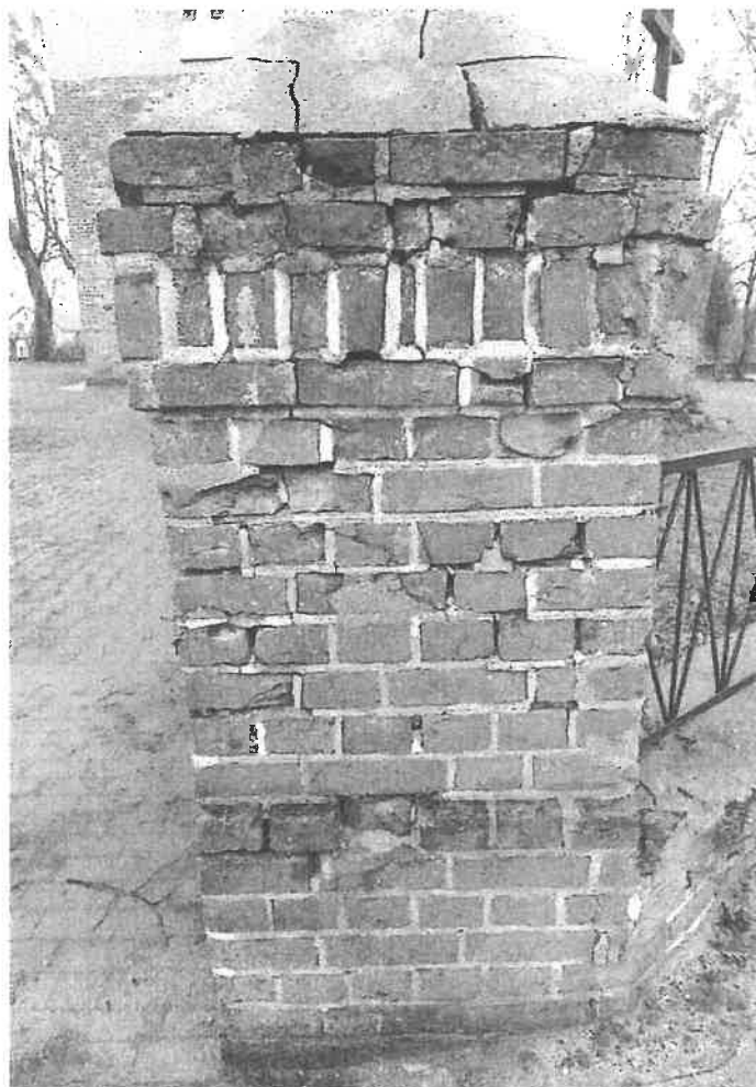
Fot. 1. Runowo, słup furtki od strony zachodniej. Widoczny bardzo zły stan. Zaleca się rozebranie słupa do poziomu gzymsu. W niższych partiach wykonać miejscowe wykucia i uzupełnienia.
