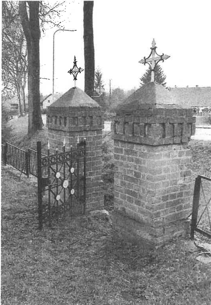
Fot. 9. Runowo, widok ogólny na wejście od strony południowej. Widoczne nieestetyczne betonowe nakrywy słupów oraz silne porażenie mikroorganizmami.
