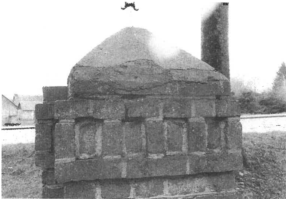
Fot. 10. Runowo, zbliżenie na nieestetycznie wykonaną nakrywę, która nie przykrywa całego słupa.
