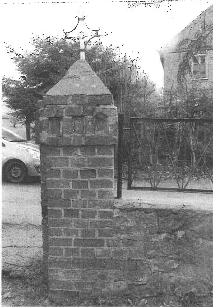
Fot. 13. Runowo, strona północna, ceglany słup wejścia od strony północnej. Widoczne nieestetyczne uzupełnienia gzymsu, wykwity biologiczne mchów i porostów.
