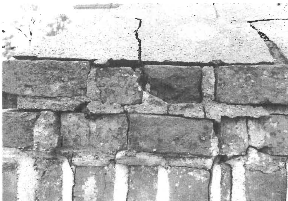
Fot. 2. Runowo, zbliżenie na górną część słupa, widoczny zły stan cegieł oraz spoin.
