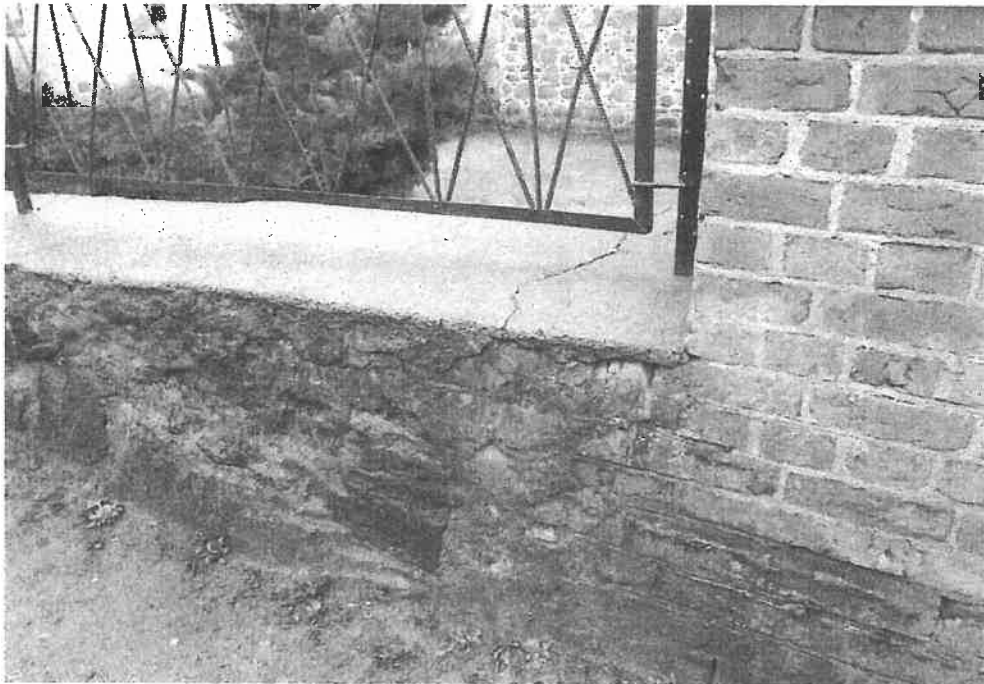
Fot. 14. Runowo, strona północna, widoczne silne zabrudzenia i zawilgocenia dolnych partii muru.
