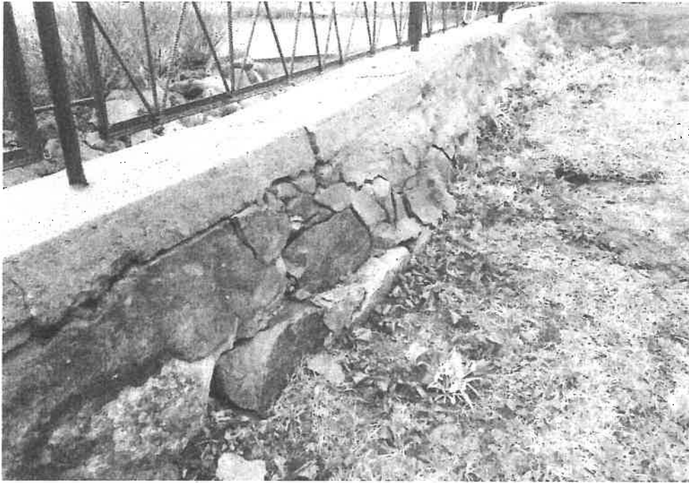
Fot. 5. Runowo, widoczne ubytki spoin w kamiennym murze oraz wtórne betonowe nakrywy.
