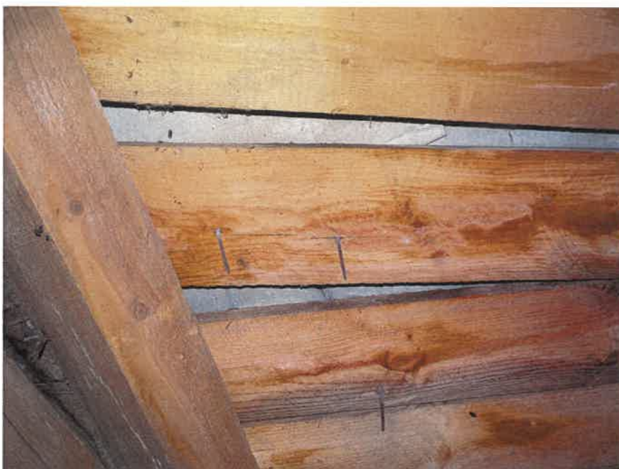
Zdj. 10. Widok deskowania – brak wiatroizolacji
