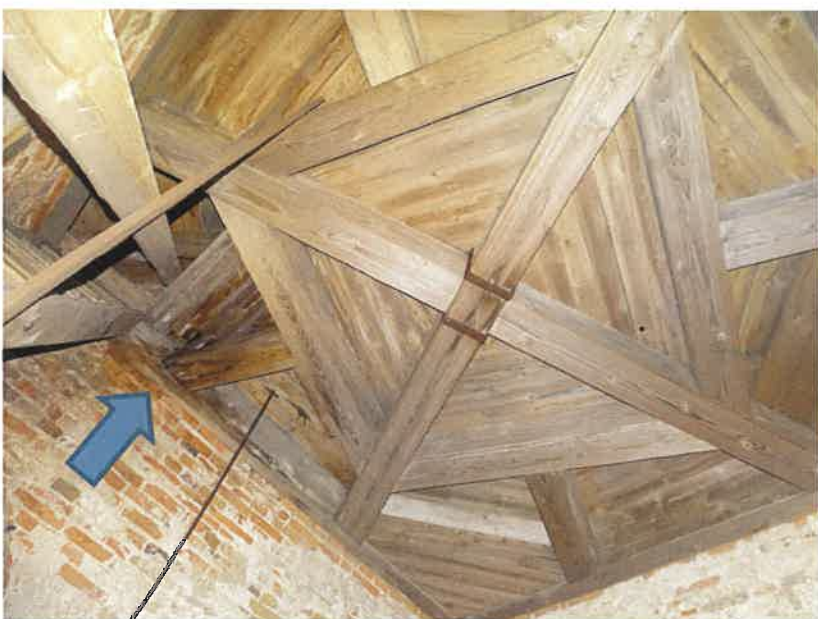
Zdj. 7. Widok ścian poniżej najwyższego stropu wieży – ubytki wypraw tynkarskich oraz belek konstrukcji stropu do wymiany
