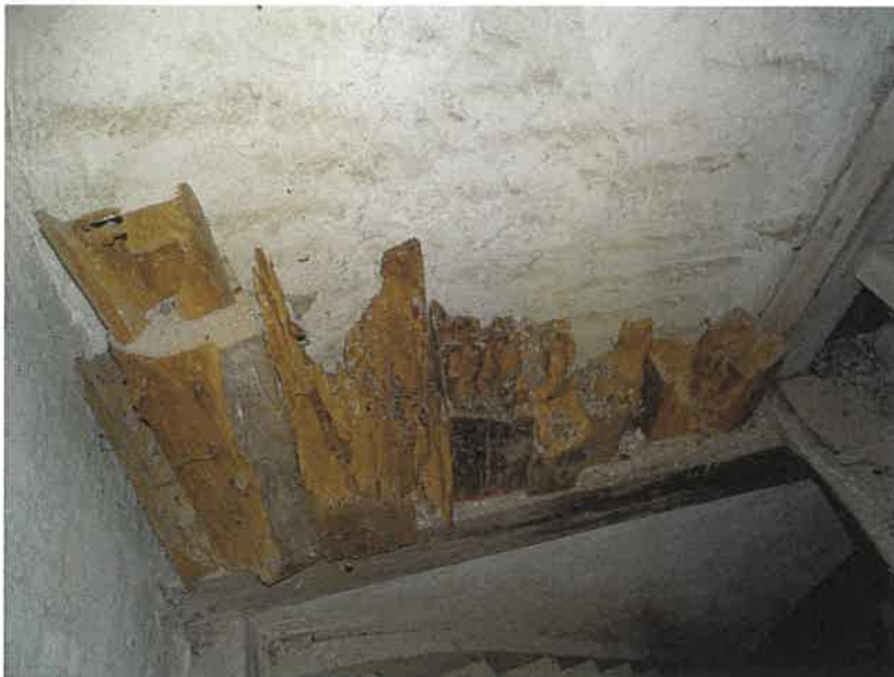
Zdj. 6. Elementy drewniane porażone korozją biologiczną przeznaczone do usunięcia
