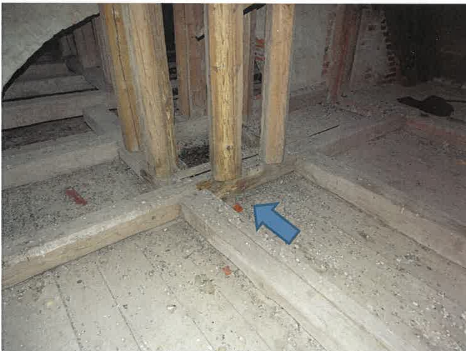
Zdj.13. Belka konstrukcji wsporczej sygnaturki przeznaczona do wymiany
