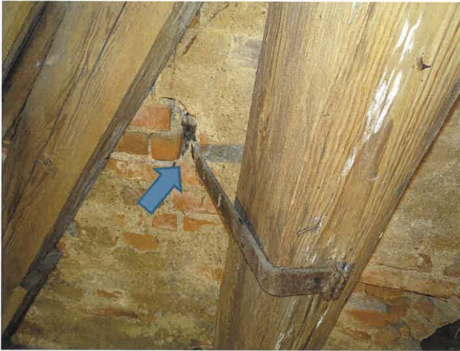
Zdj. 12. Przekorodowana klamra stalowa mocująca zastrzał do muru wieży
