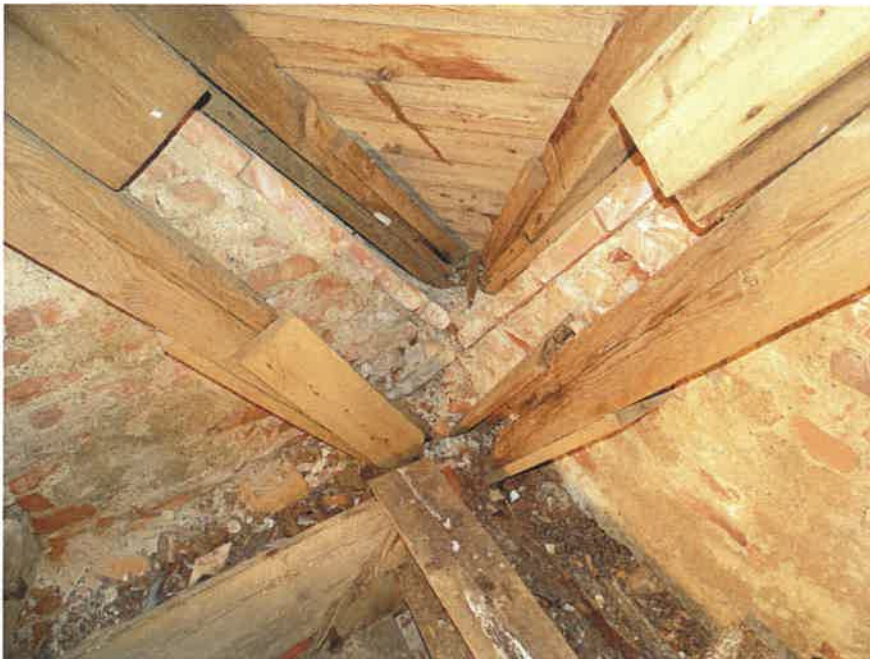
Zdj. 8. Końcówki krokwi porażone korozją biologiczną przeznaczone do remontu
